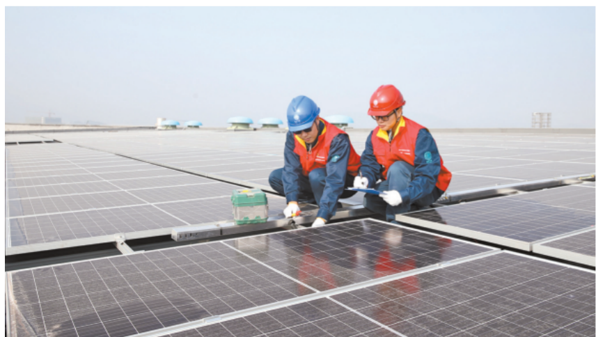
近日，国网金华供电公司组织共产党员服务队，开展屋顶分布式光伏发电项目上门巡检活动。图为服务队队员对横店影视产业园摄影棚的屋顶光伏组件进行全面检查，排查电缆接头是否牢固，并网保护设备是否正常运行。
